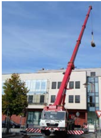
Die Stadtverwaltung Marktheidenfeld setzt auf dem Rathausdach auf eine moderne Photovoltaik-Anlage. Foto: Torsten Ruf
